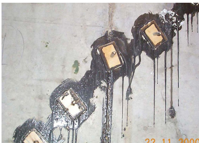
Рис. 34. Штуцера для низконапорной технологии инъектирования, наклеенные вдоль трещины
