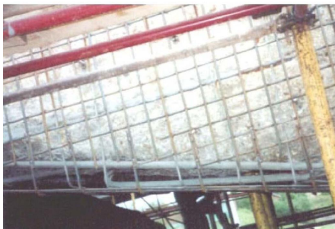
Рис. 23. Восстановление несущей способности балки с помощью дополнительного армирования.
