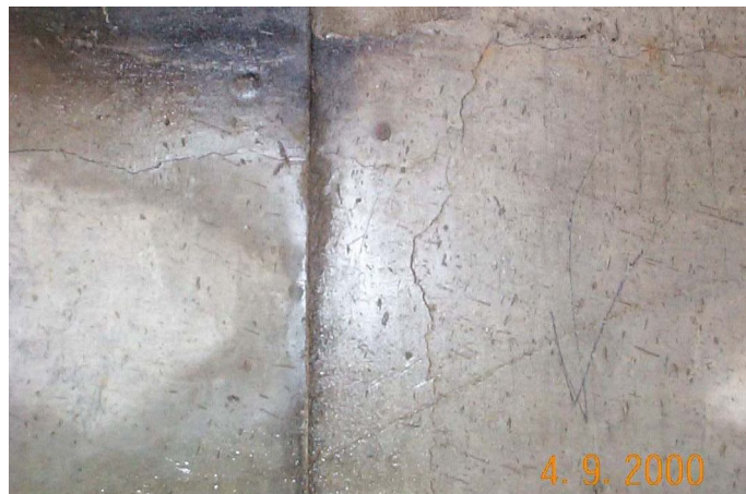
Рис. 6. Усадочные трещины на поверхности стены .
