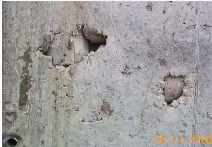
Рис. 5. Зависание бетонной смеси в зоне «сухарей»
