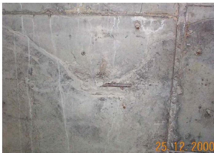
Рис. 1. Участок стены с оголенной арматурой
